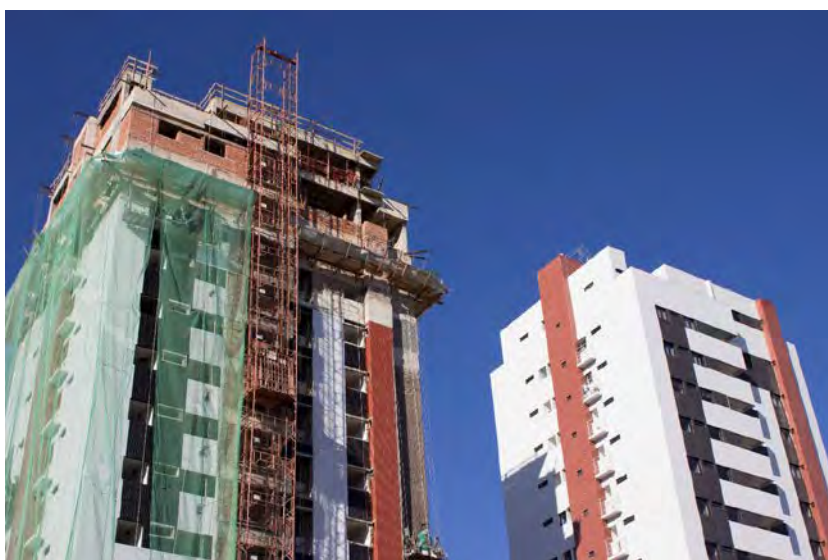
Imagens 54-55: Inserção do Residencial Paradise Beach na praia de Guaxuma e detalhe das fachadas.
